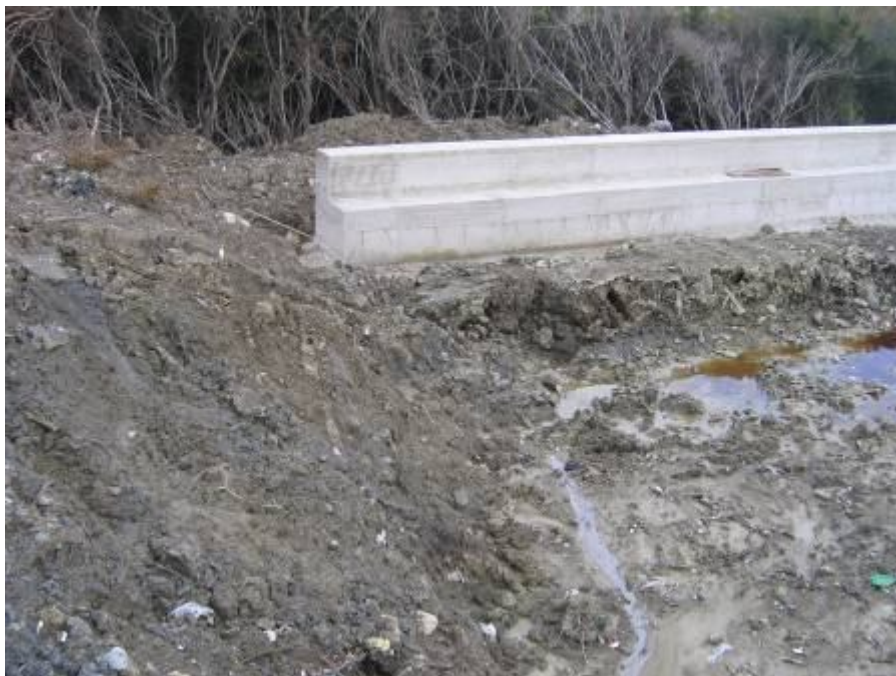
Foto 2: argine troppo basso (50cm), per cui si rischia in caso di pioggia la fuoriuscita di percolato diluito con acqua
