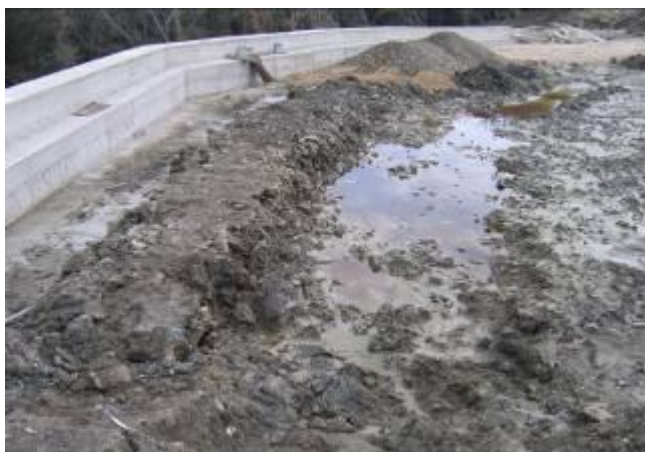
Foto 1: Accumulo di percolato nella vasca comunale
