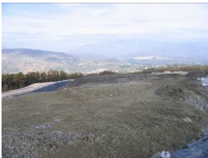
Foto 14: Discarica chiusa alle ore 12:45 senza la copertura dei rifiuti
